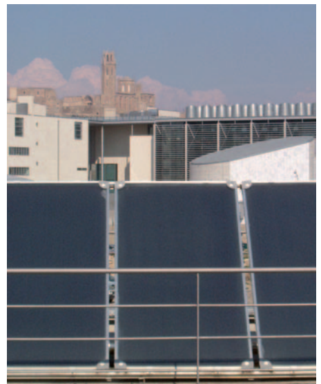
L'EQUIPAMENT SOLAR TÈRMIC DEL CREA. © CREA
