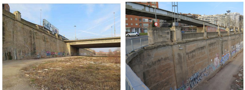
Estat actual del mur a l'entorn del pont Nou, possible localització de la nova rampa a construir.
