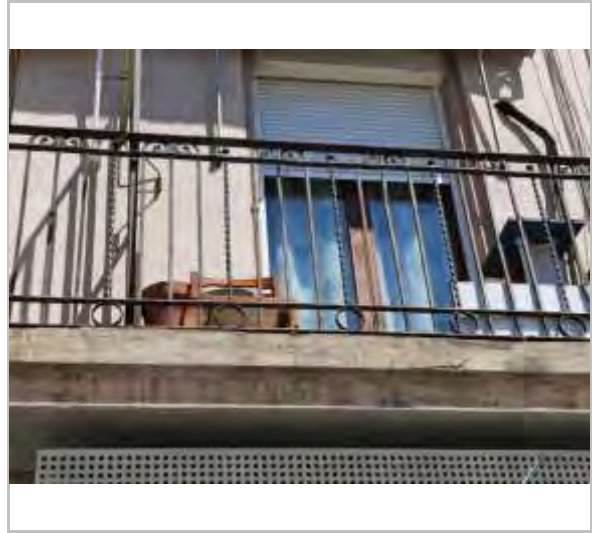
Detall restes impactes en balcó Av. Del Segre, 12 Grup de Recuperació de la Memòria Democràtica
