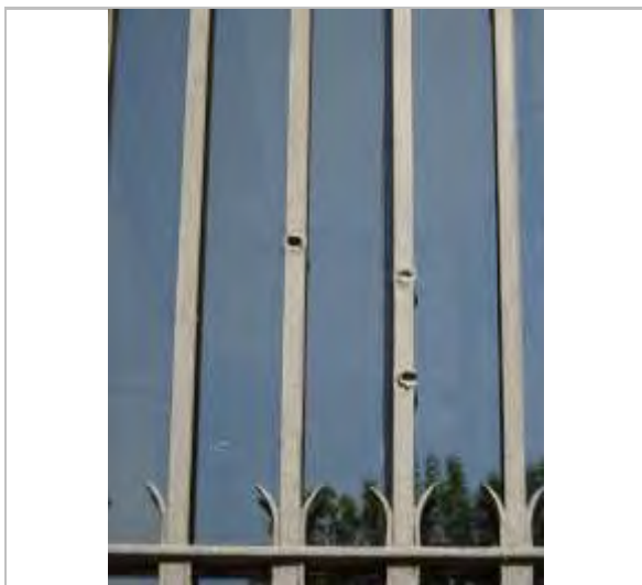
Impactes en reixes de façana de l'Antic Palace
