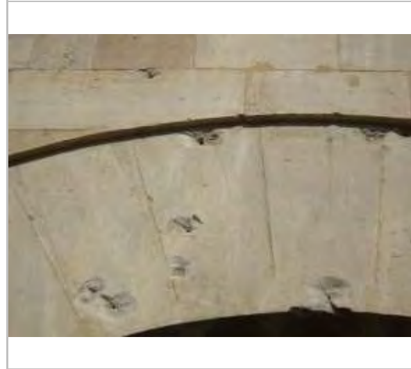
Detall impactes en façana de l'arc del Pont Grup de Recuperació de la Memòria Democràtica
