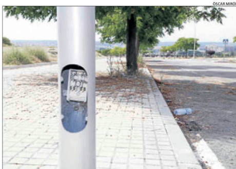
Fanals i altres instal·lacions de Torre Salses han estat saquejats.
